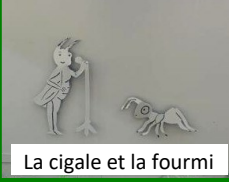
plaques dissimulant des armoires électriques
