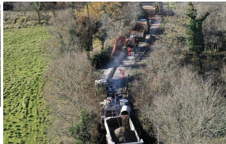
Connexion des 2 châteaux d'eau de Rul à Candare, par le Syndicat Mixte des eaux du Causse de Martel et de la vallée de la Dordogne
